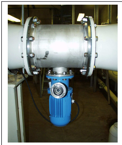
Abb. 1: Eingebauter Mischer mit Flansch für FHM-Dosierung
